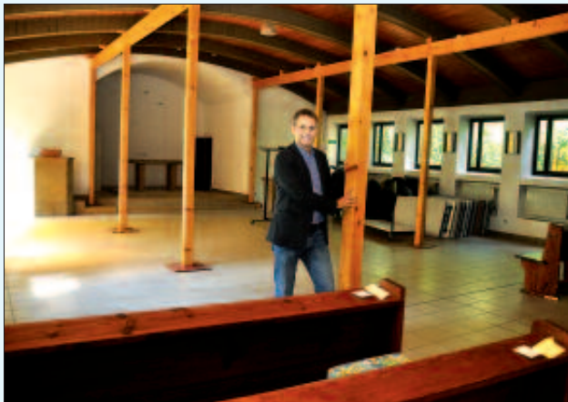
■ Aufgrund neuer Bestimmungen über erhöhte Schneelast wurde das Dach von der Kirchengemeinde durch Stützen verstärkt. Dies soll durch eine Dachsanierung verändert werden.
